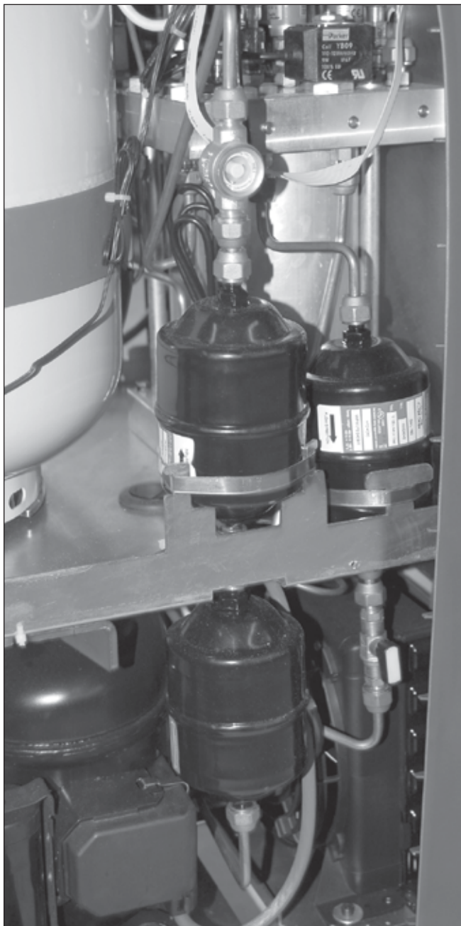
La tubería interna de la máquina de R/R/R se debe revisar periódicamente para cerciorarse que no hay fugas presentes.
