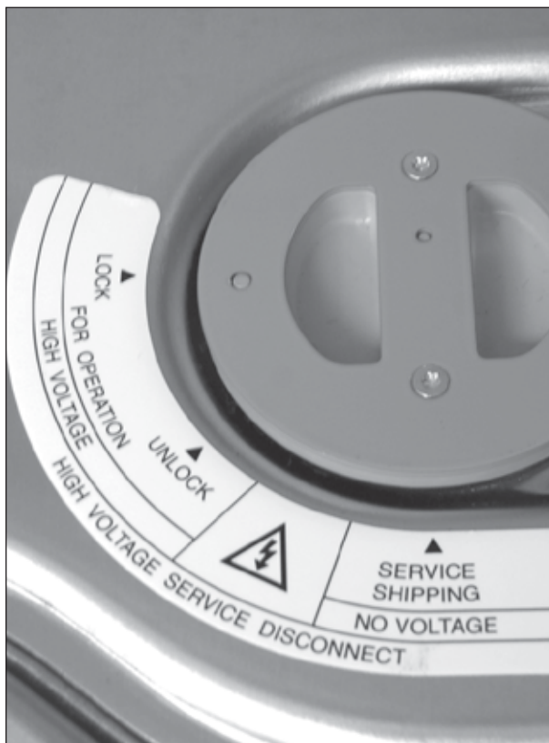
Este es un ejemplo de un dispositivo de desconexión del alto voltaje en un vehículo híbrido. Cuando trabaje en cualquier vehículo híbrido o eléctrico, SIEMPRE siga los procedimientos de seguridad recomendados por el fabricante.
